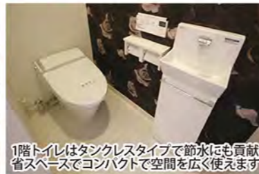
1階トイレはタンクレストタイプで節水にも貢献。省スペースでコンパクトで空間を広く使えます
